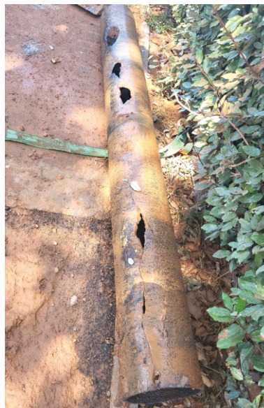
Exemple d'un tuyau d'eau potable vétuste après une rupture de canalisation
